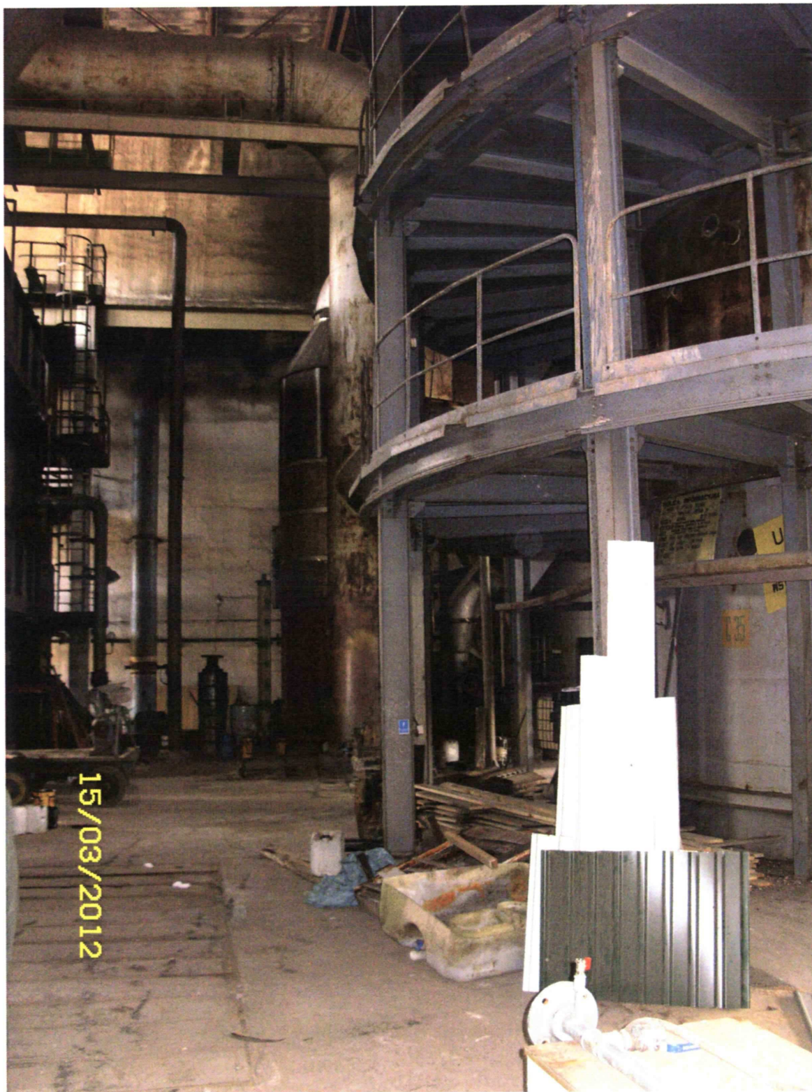
Spalarnia – konstrukcja pieca
