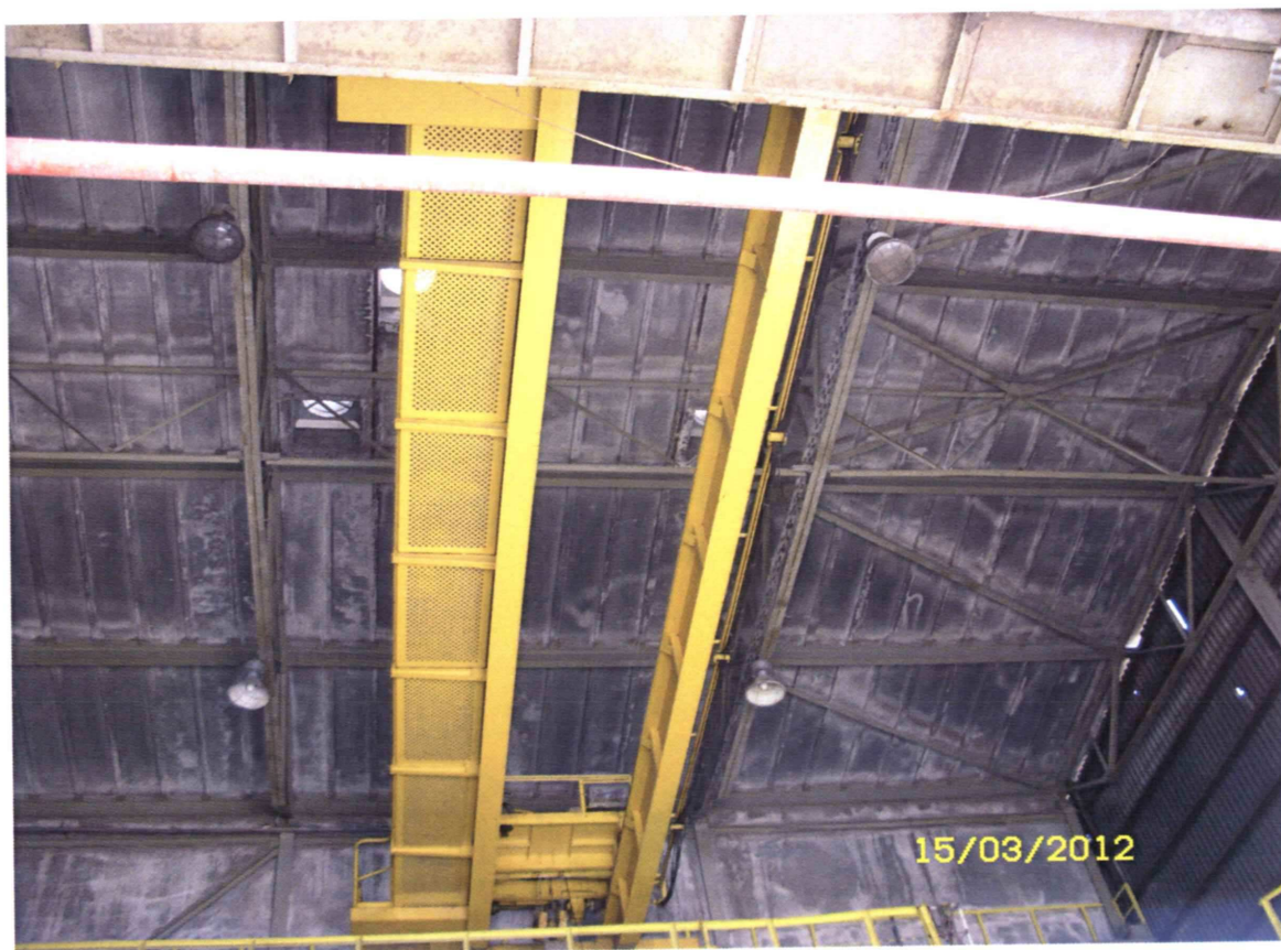
Hala odpadów – konstrukcja dachu oraz suwnica
